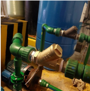
Plomería (sistema PPR)
