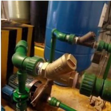
Plomería (sistema PPR)
