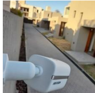
Instalación de cámaras de seguridad
